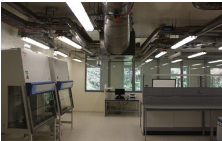
Patalpų apsauga nuo užkrato patekimo į išorę užtikrinta šiomis priemonėmis: sandarios patalpos, specialūs, didžiausi Lietuvoje HEPA filtrai paduodamam orui, dvigubi HEPA filtrai ištraukiamam orui, neigiamų slėgių kaskados skirtingose patalpose.
