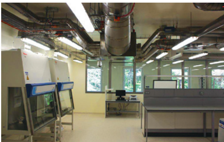
Telpu aizsardzība pret infekcijas izkļūšanu ārpusē nodrošināta ar šādiem līdzekļiem: hermētiskām telpām, speciāliem, vieniem no lielākajiem HEPA filtriem Lietuvā ieplūstošajam gaisam, dubultiem HEPA filtriem izplūstošajam gaisam, negatīva spiediena kaskādēm dažādās telpās.
