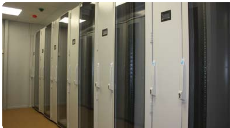
Efektiviūs duomenų centrų sprendimai padeda taupyti elektros energiją ir pinigus.
